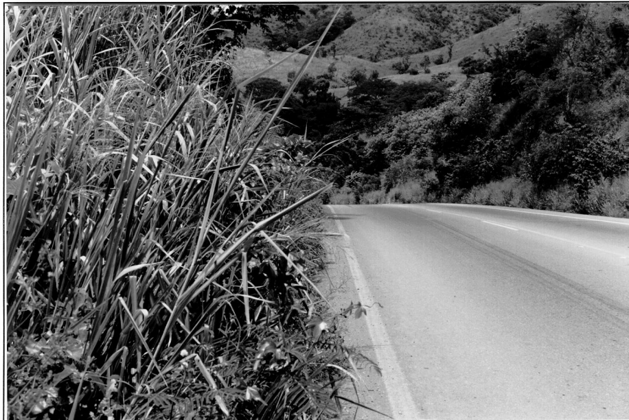
Obstrucción del escurrimiento lateral por malezas.
