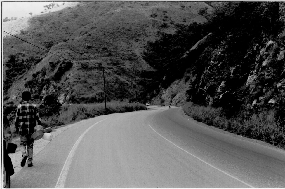
Obstrucción lateral por maleza en zona peraltada.
