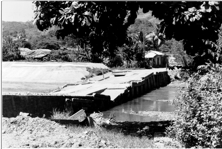
El mismo esquema sobre el río Gila; falla por socavación.
