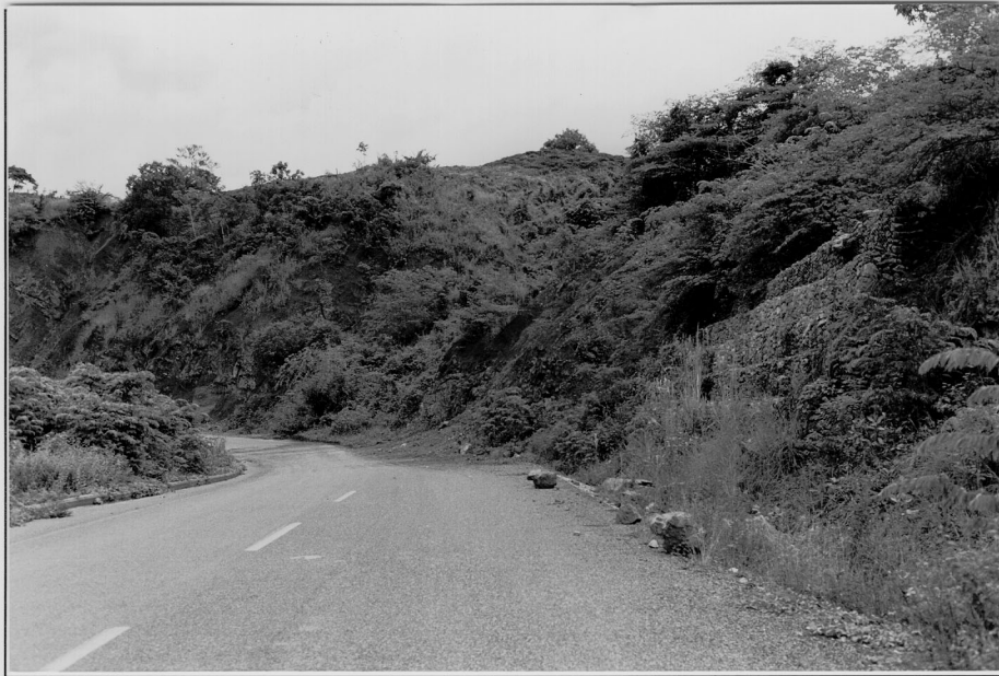
Protección de taludes con gaviones. Tramo: Pito Solo-Santa Bárbara. No obstante se observan desprendimientos y deslaves peligrosos para el usuario.
