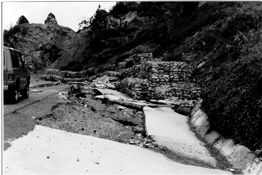
Socavación en zona de hombro y conducción lateral.
