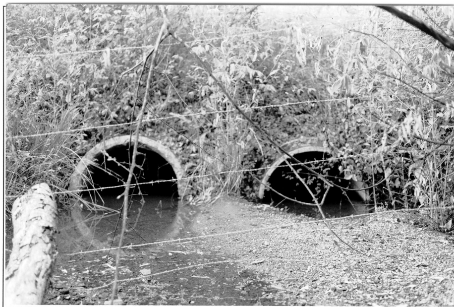
Alcantarilla sin cabezales. Tramo: Pito Solo - Santa Bárbara.
