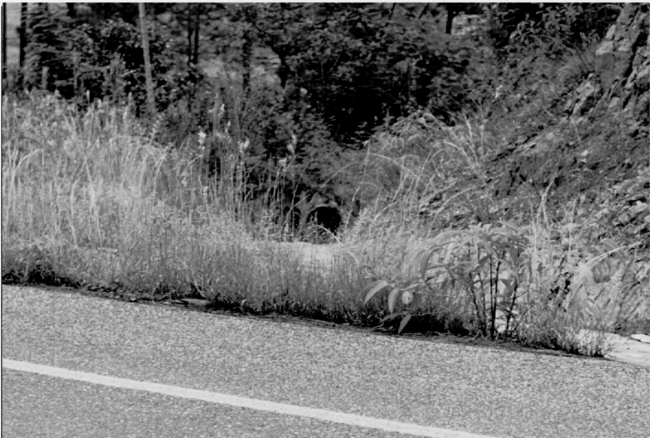
Captación de cunetas laterales conducida por tubería para evitar deslizamientos y erosión.
