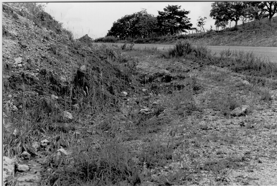
Erosión en cunetas.
