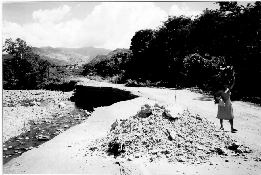
Daños provocados por el río.
