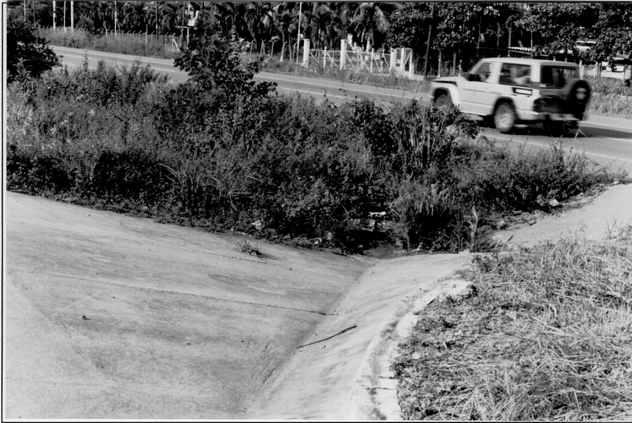
Desagüe zona central de autopista. Boulevard Villanueva- San Pedro Sula.
