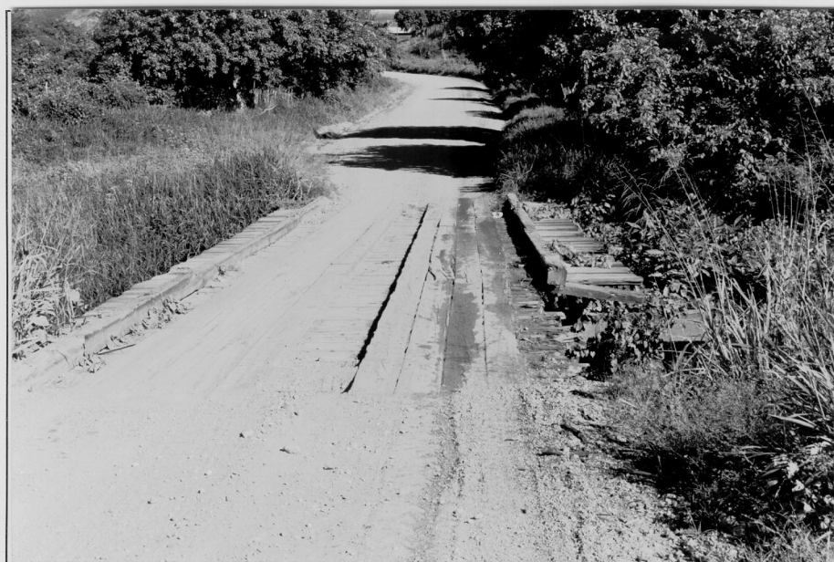
Puente precario. Acceso a las zonas del Cayo Coyoles Central. Olanchito.
