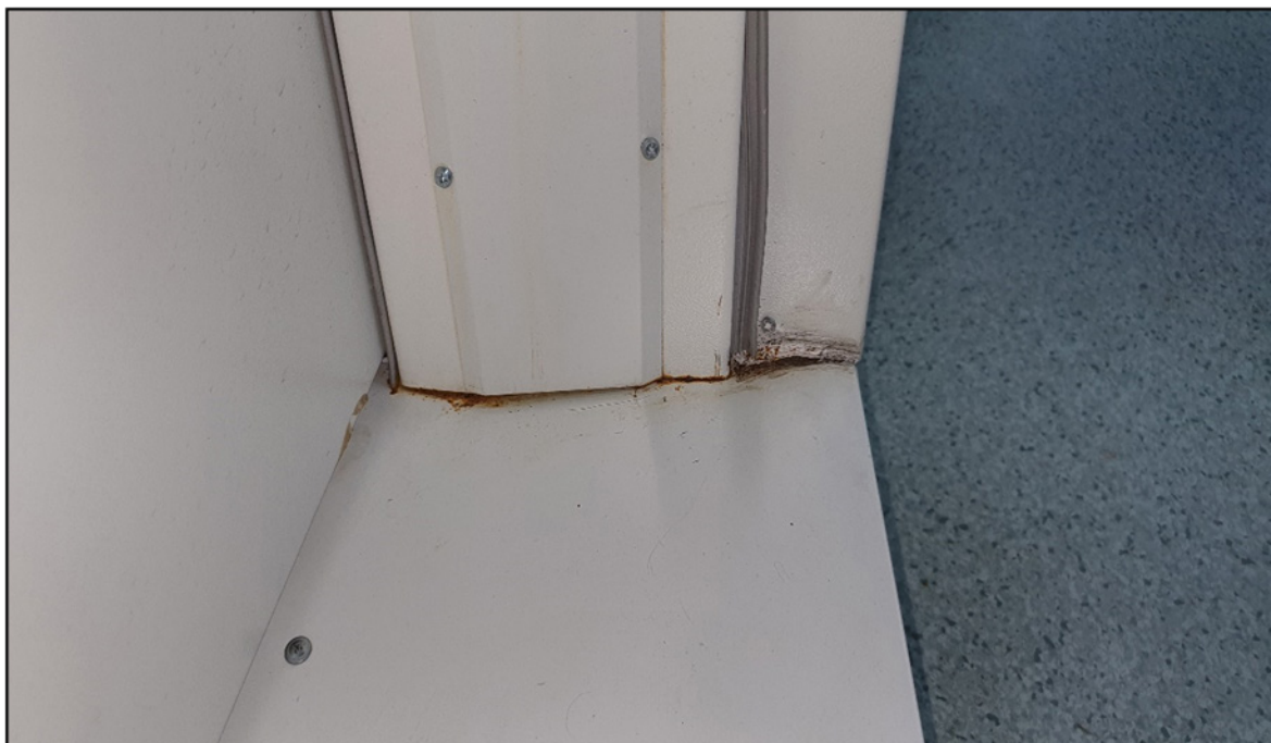
Óxido y corrosión en juntas de paneles de puertas de accesos de todo el hospital.
