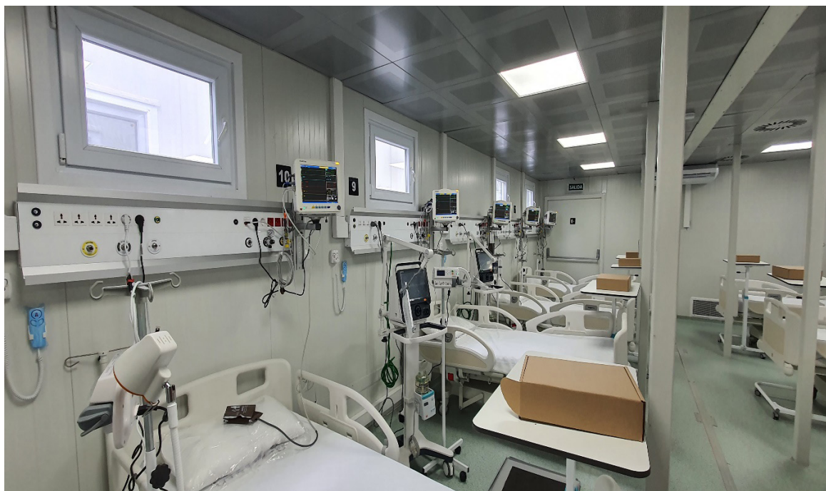
Área de UCI con insuficiente espacio para paciente requerido de 15 metros cuadrados por paciente, imposibilidad para traslado de paciente a baños y salida de emergencia inhabilitada.
