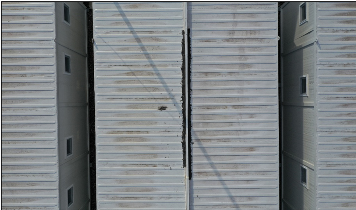
Óxido y corrosión en techo y aplicación de selladores impermeabilizantes.
