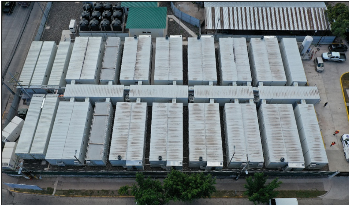
Todos los módulos cuentan con óxido y dos de ellos almacenan agua en el techo.
