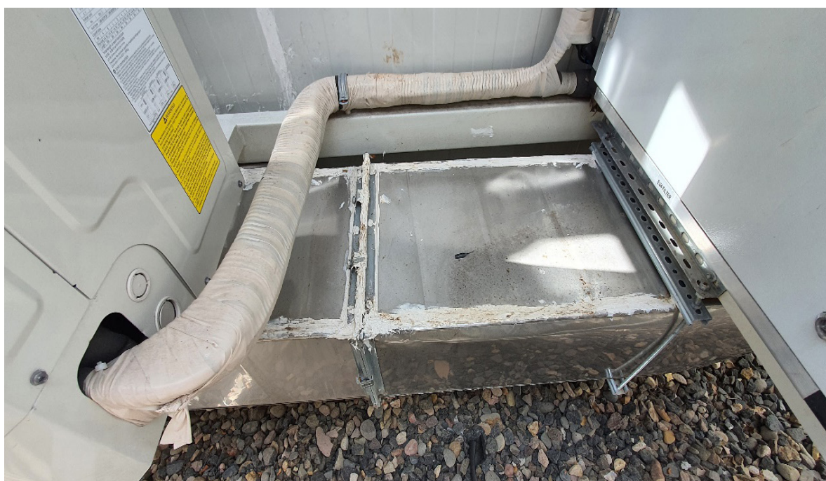
Sistema de climatización VRF-AHU no funciona; se desconoce su estado de garantía.
