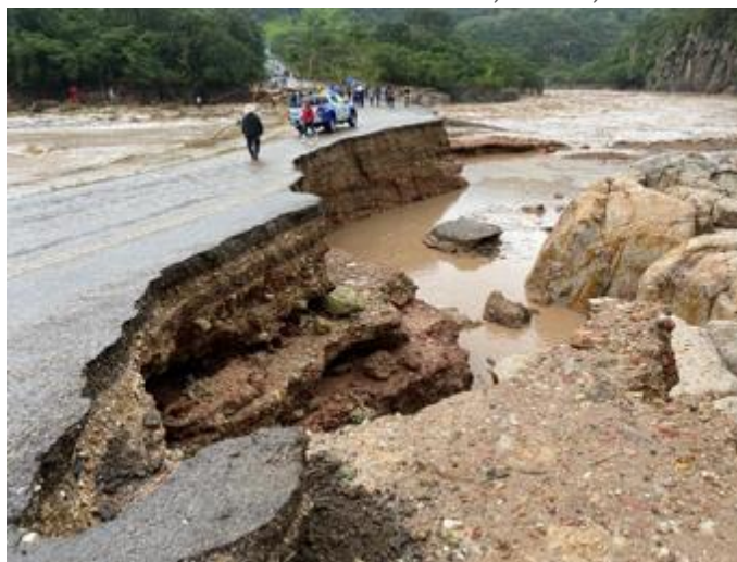
IMAGEN 2. COLAPSO DE PUENTE HIGUITO, TALGUA, LEMPIRA
