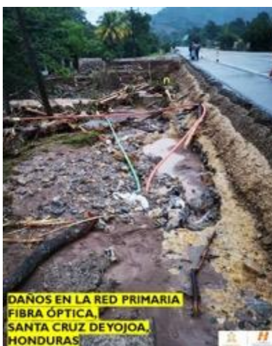
IMAGEN 4. DAÑOS EN LA RED PRIMARIA FIBRA OPTICA
